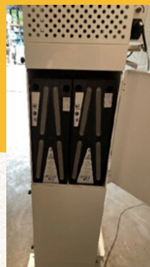
Armoire contenant 8 modules
